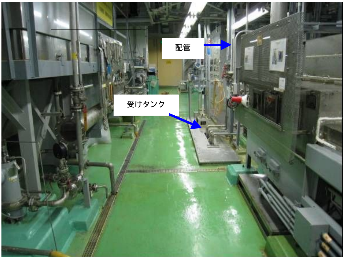
1階 受けタンク及び配管
