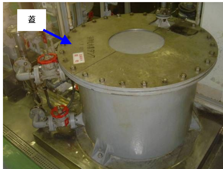
2階 過酸化水素水タンク
