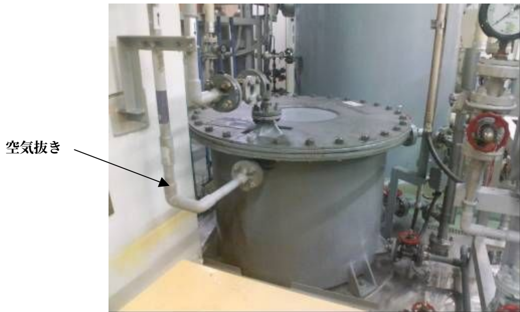
添付 12-写真 1（過酸化水素水タンクの空気抜き）
